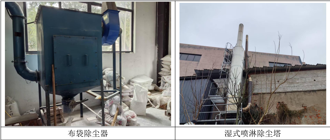
图 4-3 本项目废气处理设施照片
