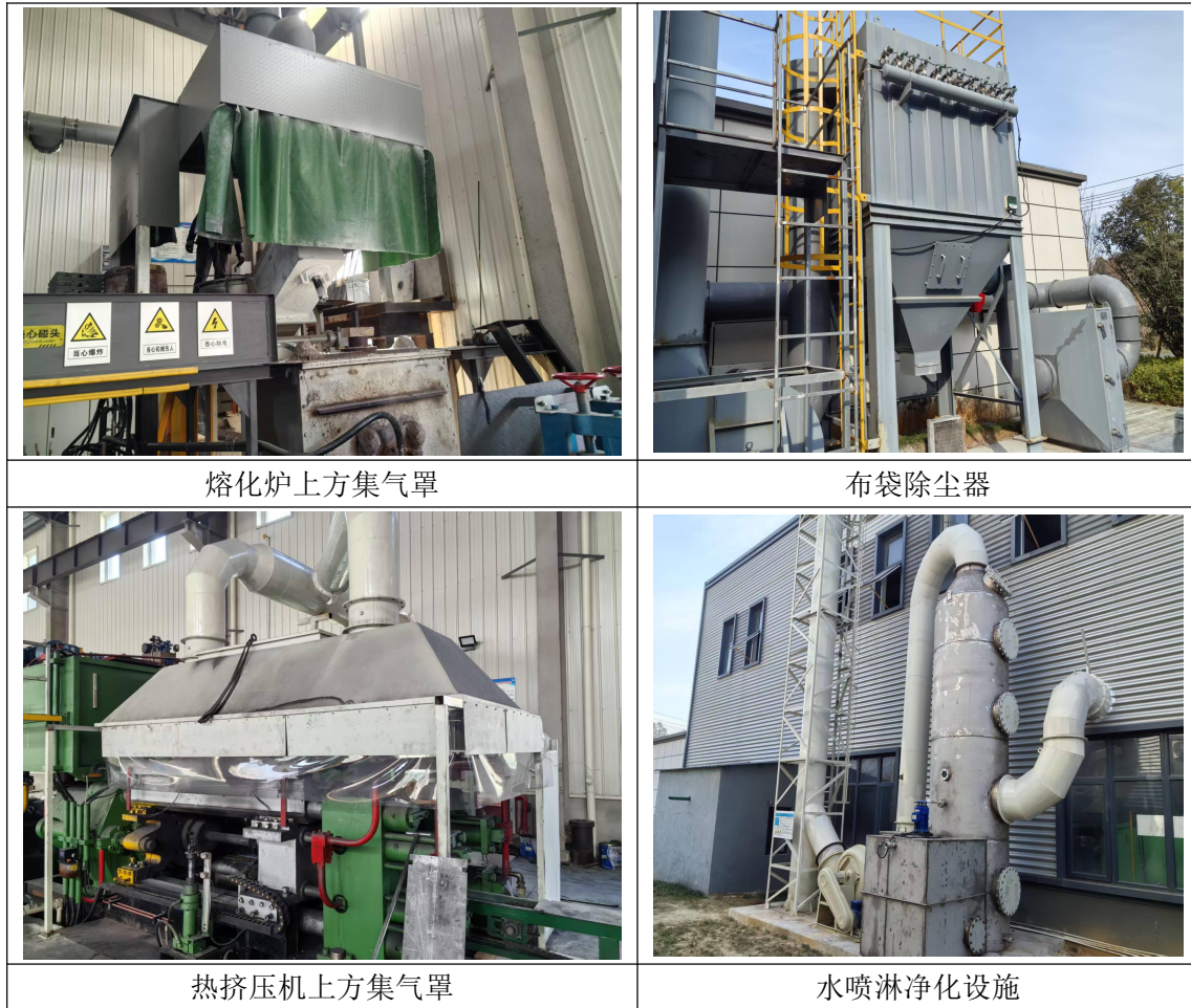
图 4-3 本项目废气处理设施照片
