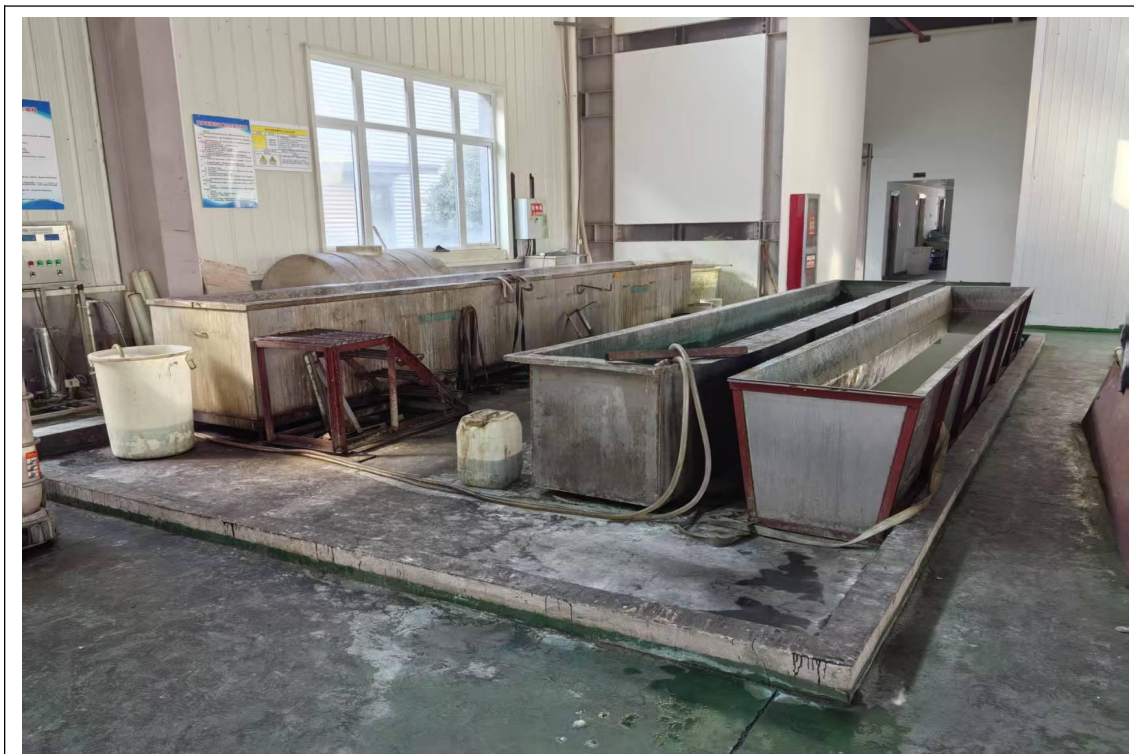
超声波清洗工序地面防渗及围堰措施
