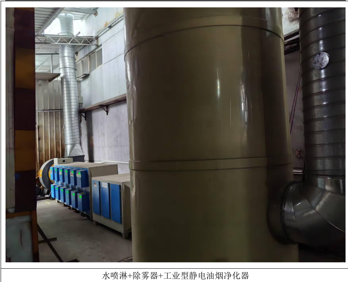
图 4-3 本项目废气处理设施照片
