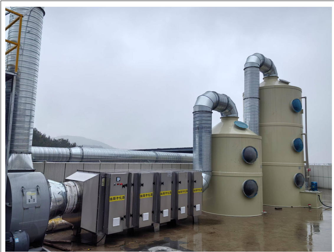
水喷淋+除雾器+工业型静电油烟净化器
