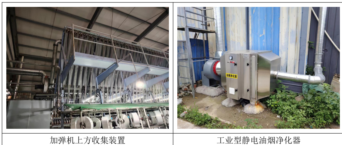
图 4-3 本项目废气处理设施照片
