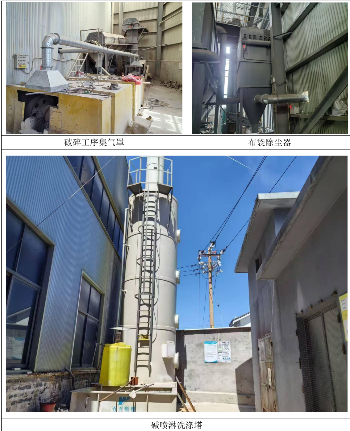
图 4-3 本项目废气处理设施照片
